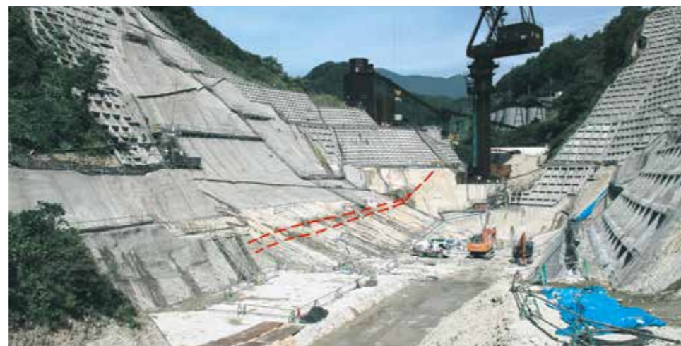
赤線がF-V断層 ダムサイトの直下を走る
