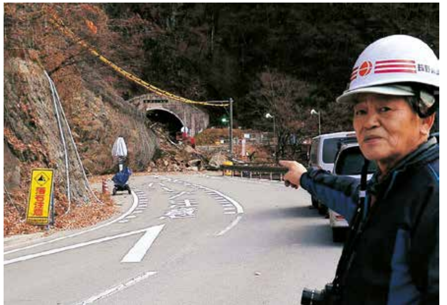
リニア関連工事の影響による土砂崩落現場を緊急視察 （12月16日・中川村地籍の松川インター大鹿線）
